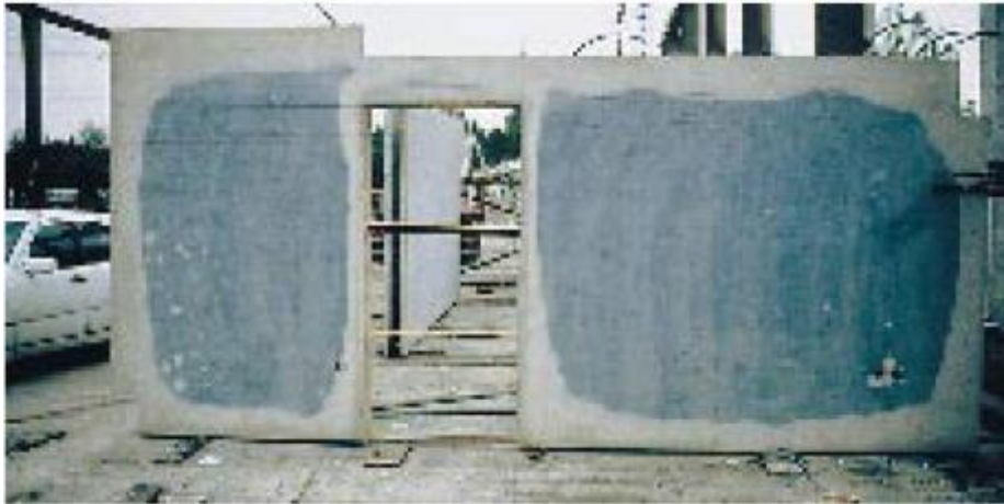
Bild 22: Blaufärbung eines Fertigteils mit Hochofenzement nach dem Ausschalen [Lit 32]
